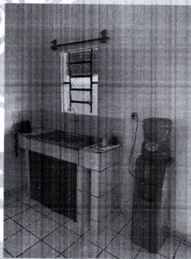
Figura 4 – Vistas de pia e bebedouro em bom funcionamento.
