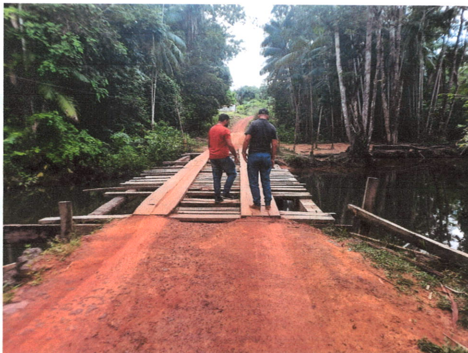
Imagem 1: Vista frontal da ponte com várias peças com defeitos e faltantes
