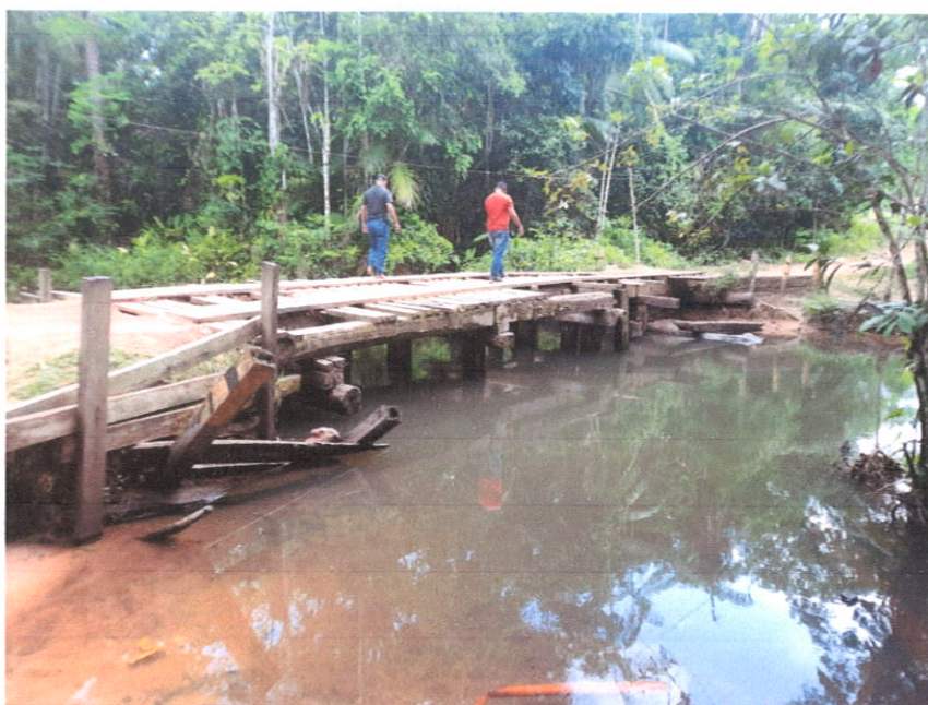
Imagem 2: Vista lateral da ponte, com diversas peças da contenção e transversinas quebradas
