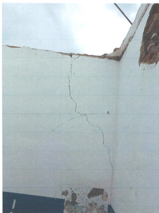
Imagem 2: Parede com rachadura acentuada.
