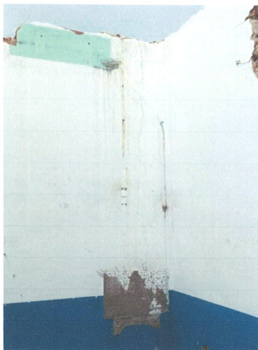
Imagem 1: Parede com rachaduras
